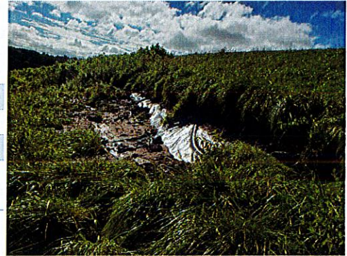
Landfill Cap Erosion
